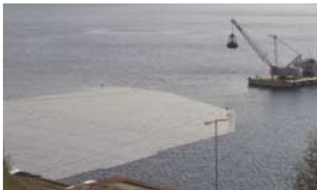
Fig. 4. Utlegging av duk (membran) som underlag for tildekking med pukk utenfor et kaiområde i Kristiansandsfjorden. (Foto: Harald Eik, Falconbridge nikkelverk as)
